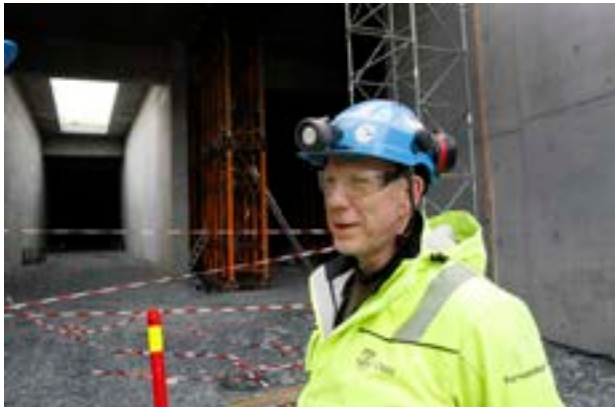
Bjørn Innhaug vet mer enn de fleste om den gigantiske byggegropa ved endestasjonen på Fornebu.
